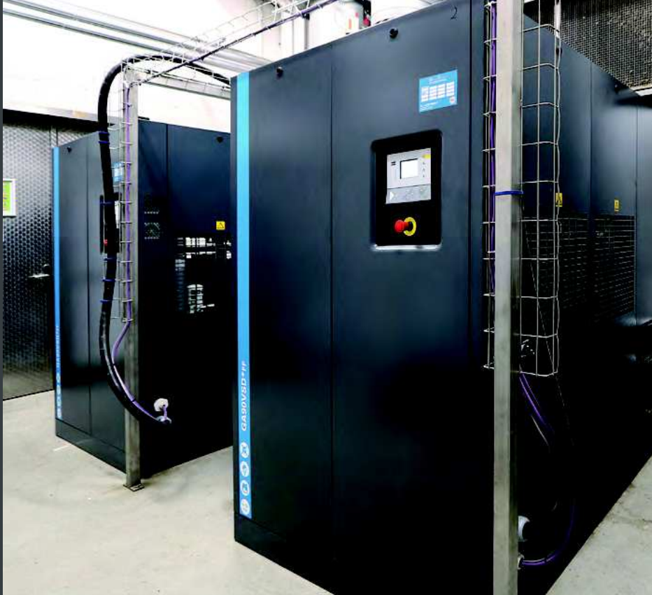
◀ In der modernisierten Kompressorstation stehen drei drehzahlgezielte Schraubenkompressoren des Typs GA VSD+ FF – zwei mit 90 kW Leistung (hier im Bild) sowie einer mit 55 kW, der hinter der Tür in einem kleinen Nachbarraum steht.
